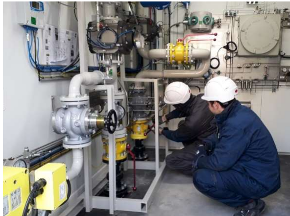
Vue intérieure d'un poste d'injection biométhane - Crédit Photo GRDF
