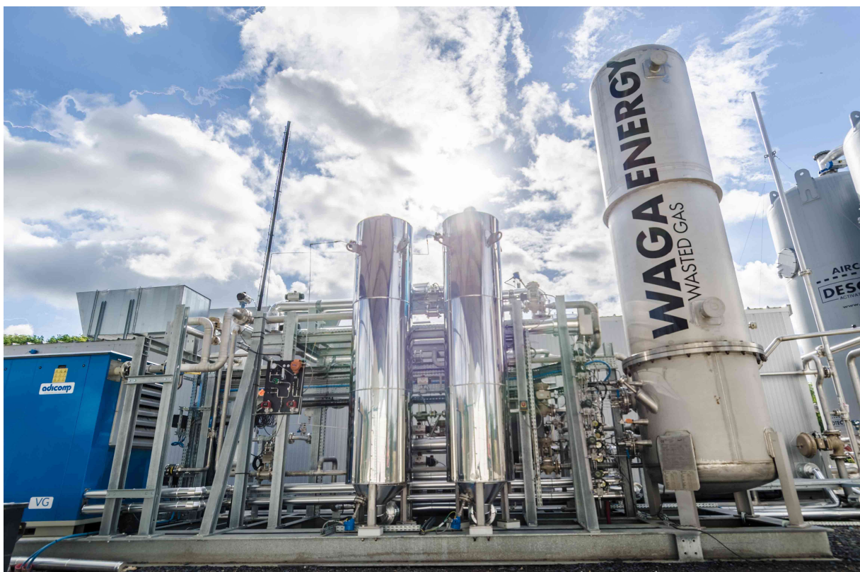
Crédit photo WAGA ENERGY : Installation WAGABOX - Site ISDND Saint-Maximin
