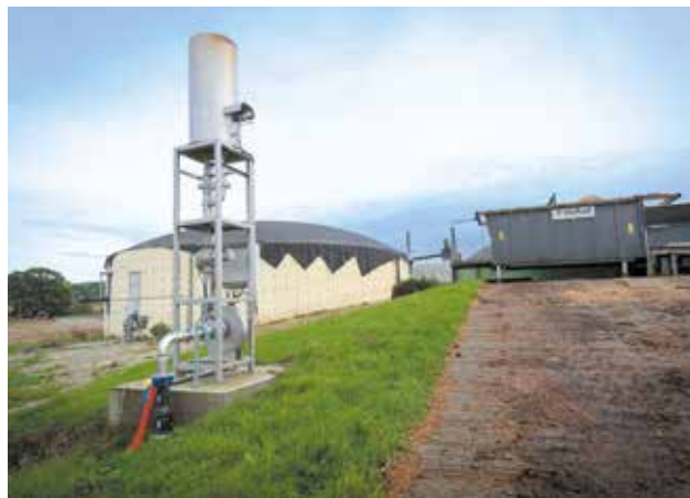
La torche est mise en fonctionnement pour des raisons de sécurité lorsqu'il faut détruire le biogaz.
