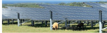
Installation PV au sol fixe - © Opale Energies Naturelles
