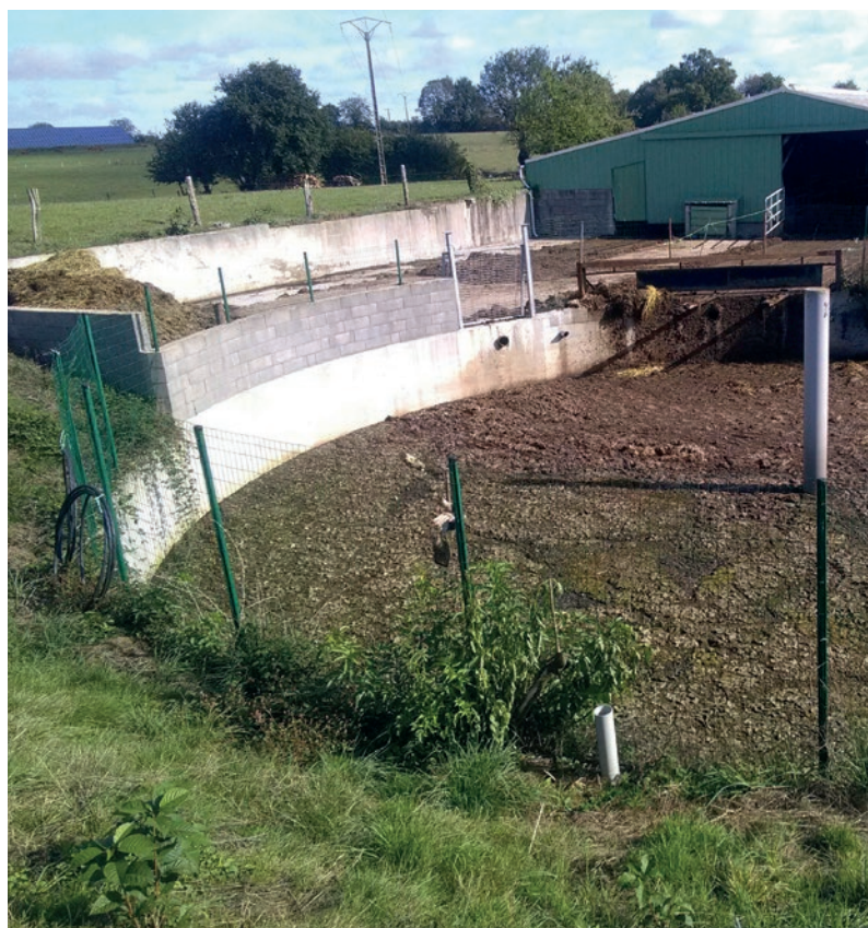
Lagune de stockage (Crédit : FRCUMA Ouest)
