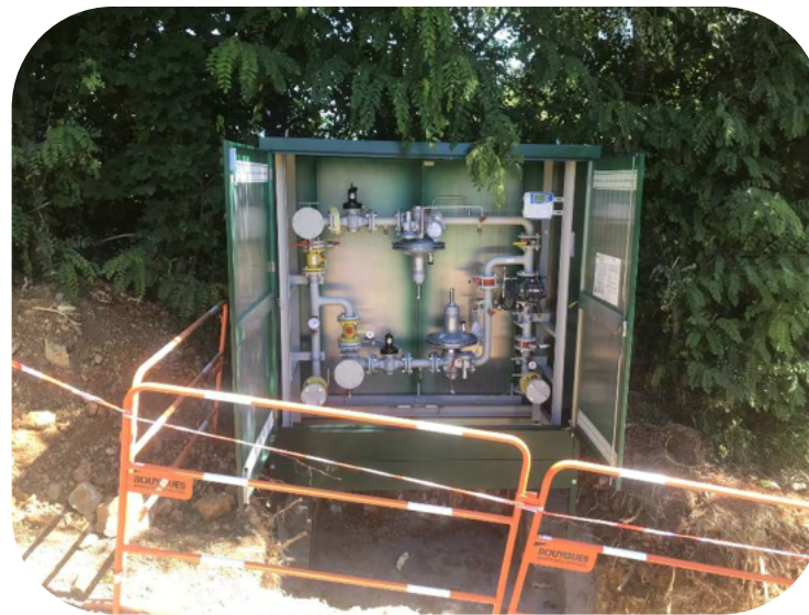
Poste déverseur à Ligugé Crédit photo : GRDF
