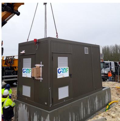
Livraison du poste d'injection
