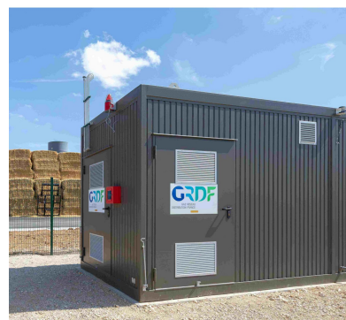
Le poste d'injection
