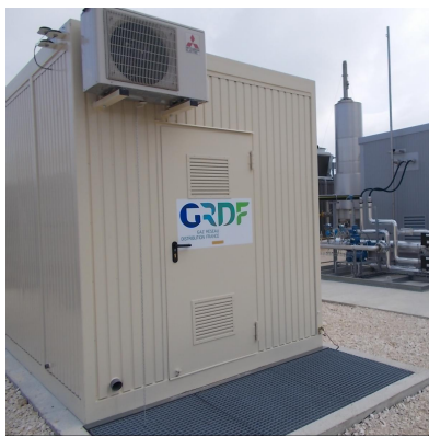
Le poste d'injection
