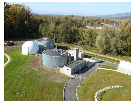
L'unité de méthanisation sur la station d'épuration.
