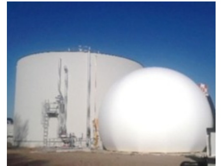
Digesteur et gazomètre
