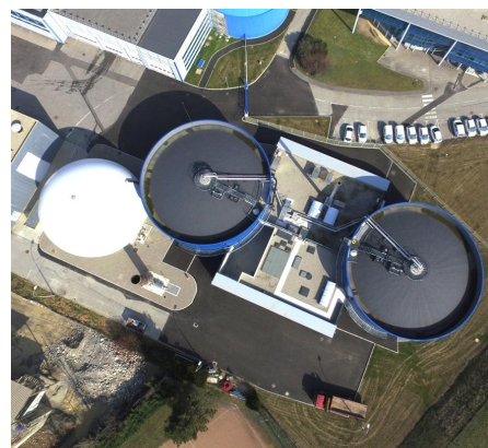
Vue aérienne de la méthanisation
