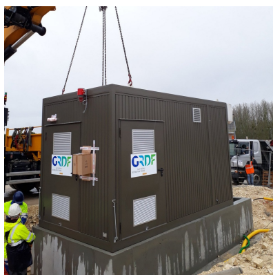
Livraison du poste d'injection
