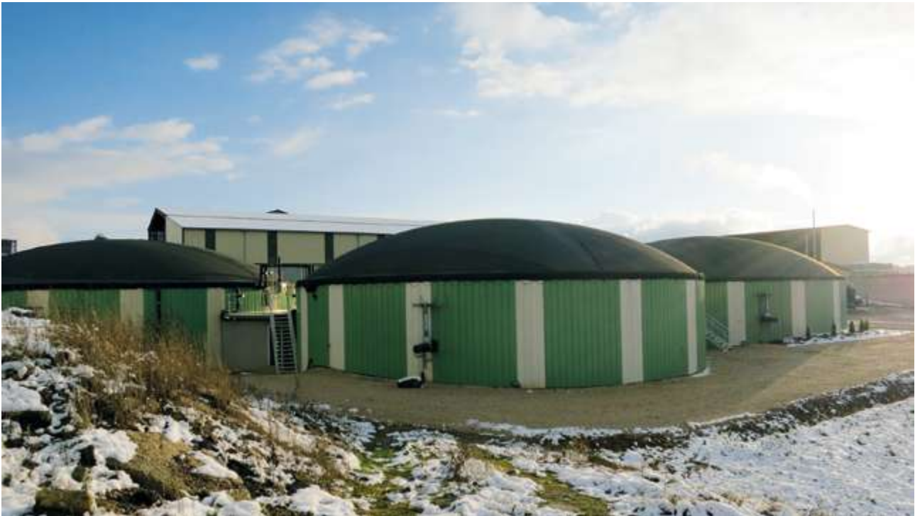
Vue de la partie digestion d'une unité de méthanisation
