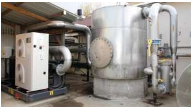
Unité de prétraitement du biogaz brut
