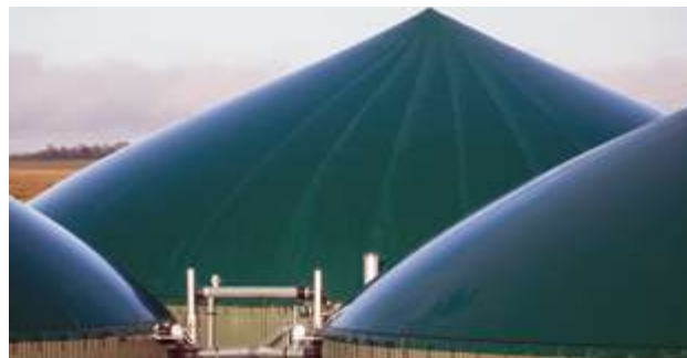
Stockage tampon de biogaz à double membrane, intégré aux digesteur et post-digesteur
