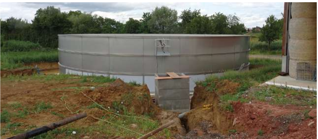
Réservoir semi-enterré de stockage de digestat
