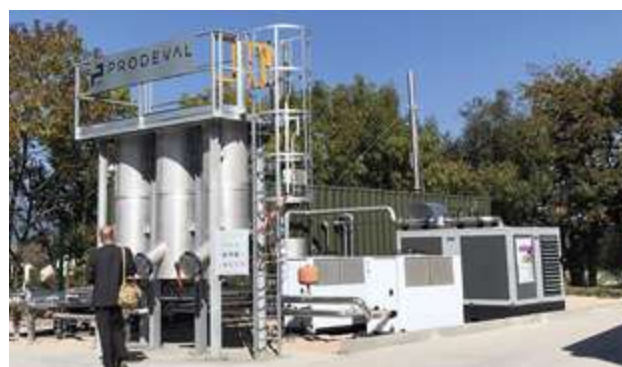
Unité d'épuration du biogaz brut prétraité
