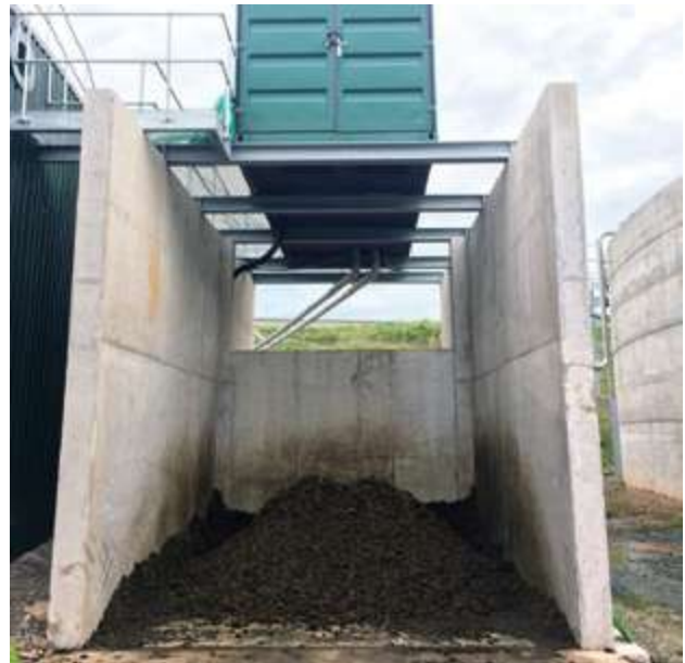
Séparation de phase de digestat brut
