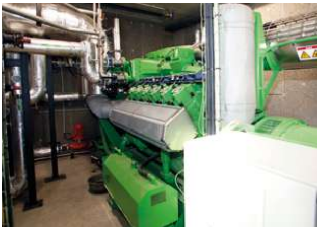
Unité de cogénération du biogaz brut prétraité
