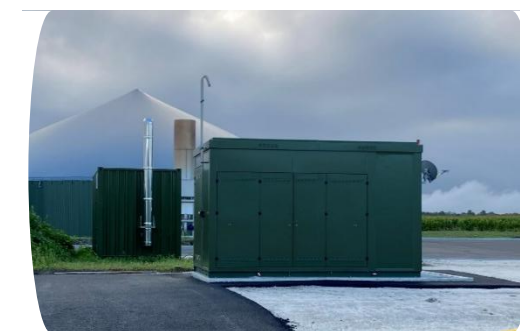
Site Médoc Biogaz 2 / Régaz-Bordeaux
