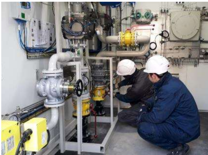
Intérieur d'un poste d'injection de GRDF (Crédit photo GRDF)
