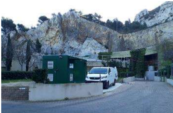
Poste d'injection GRDF de la STEP de Marseille – Crédit photo - GRDF
